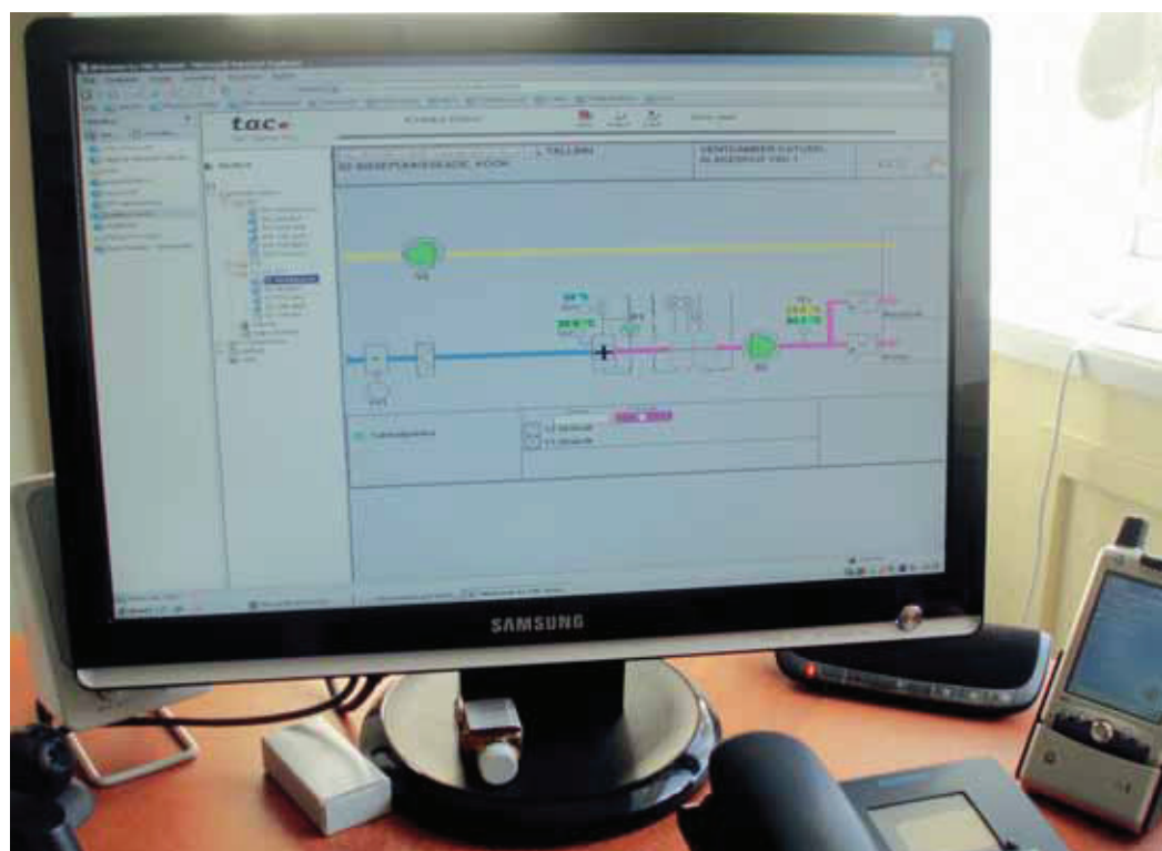
Ventilatsioonisüsteemi kaugjuhtimine arvuti kaudu: hooldaja töökoht.
