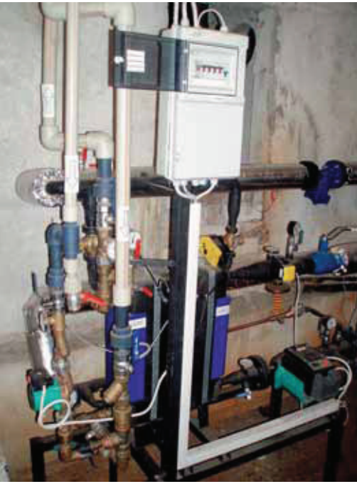
Nüüdisaegne kompaktne soojussõlm koos tema töö juhtimiseks kasutatavate automaatikaelementidega (muudetava kiirusega pumbad, temperatuuriandurid, juhtplokk, toitelülitid).
